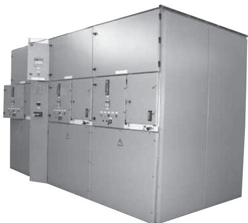
Quadro di rifasamento automatico con reattanze di filtro, tipo PFI-AX.
