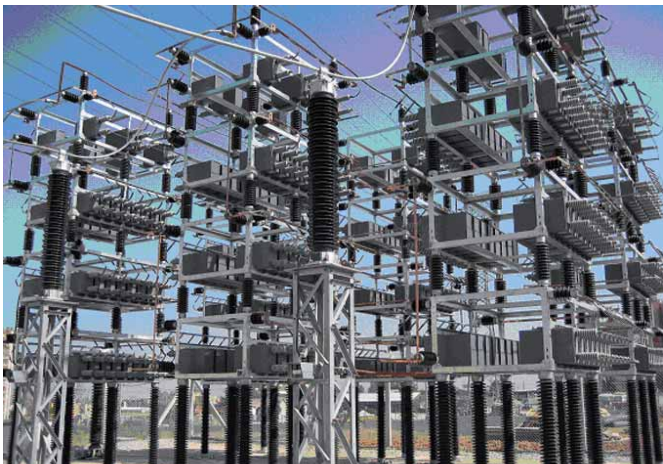
82.2 MVar - 170 kV - 50 Hz
